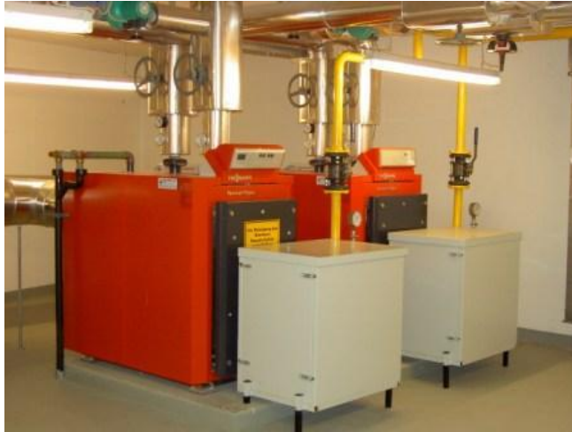
Ansicht Erdgaskessel LPPH Schrems
